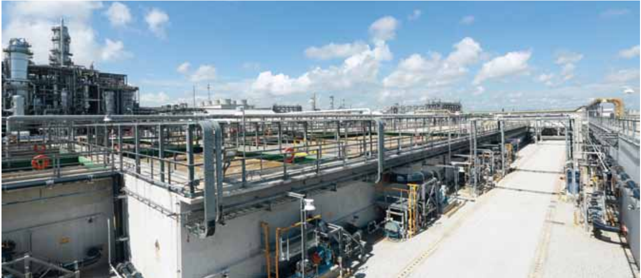
โรงบำบัดน้ำเสีย ที่นิคมอุตสาหกรรมเอเชีย
